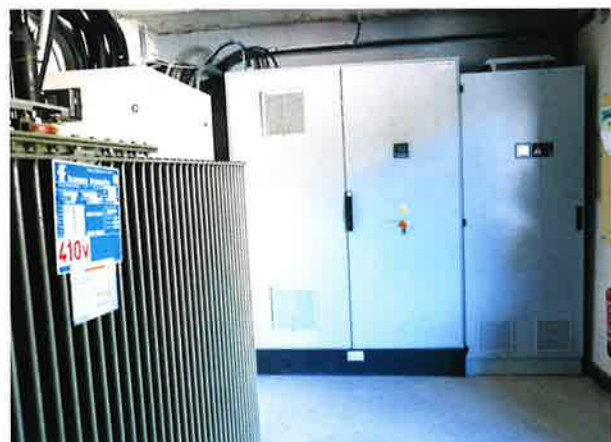
▲ Une armoire électrique et une armoire de condensateurs dédiées à la production hydroélectrique ont été implantées dans le local où préexistaient les cellules HTA et le transformateur.
